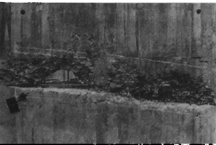
Fig. 4. Detalle de zona 9 de Fig. 1. Defectos debidos a insuficiencia de compactación.
