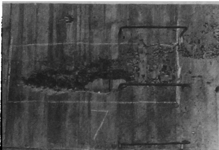
Fig. 2. Detalle de la zona 7 de la Fig. 1. Defecto debido a insuficiencia de compactación por picado.
